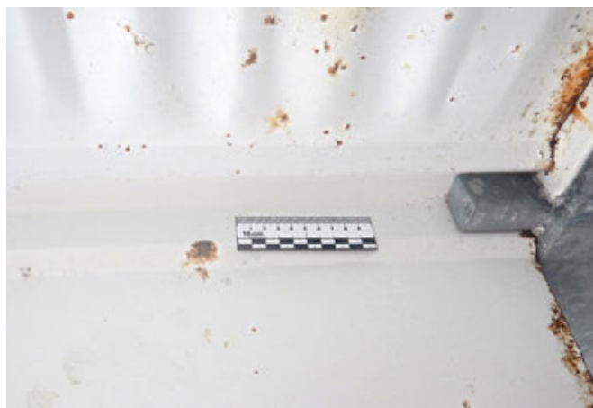
Rostflecken und erste Perforationen an der Blechunterseite – typisches Schadensbild der Hinterläufigkeit
