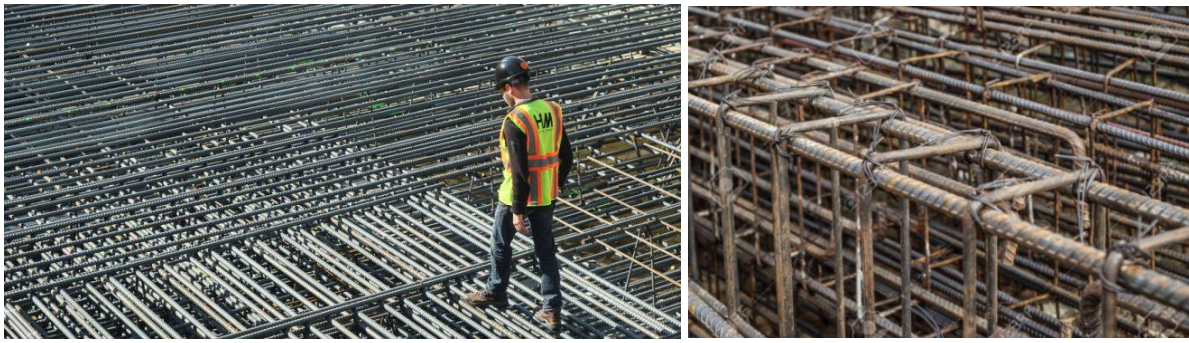
Fig.57: Bewehrungskonzentrationen, reinforcement concentrations.
